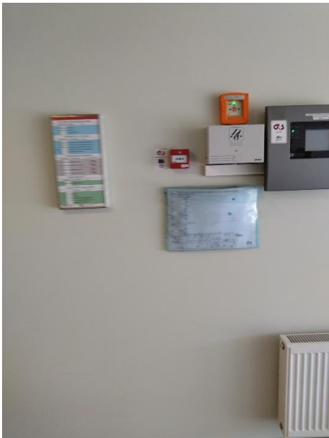
Tulekahjuteadusti nupp peasissepääsu läheduses
